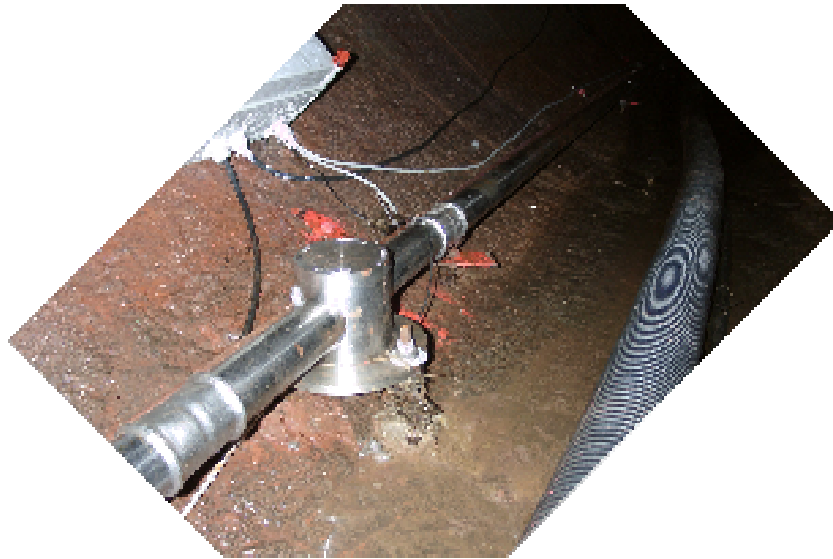
Abb. 10: 50mm-Rohrleitung im Katzestollen
